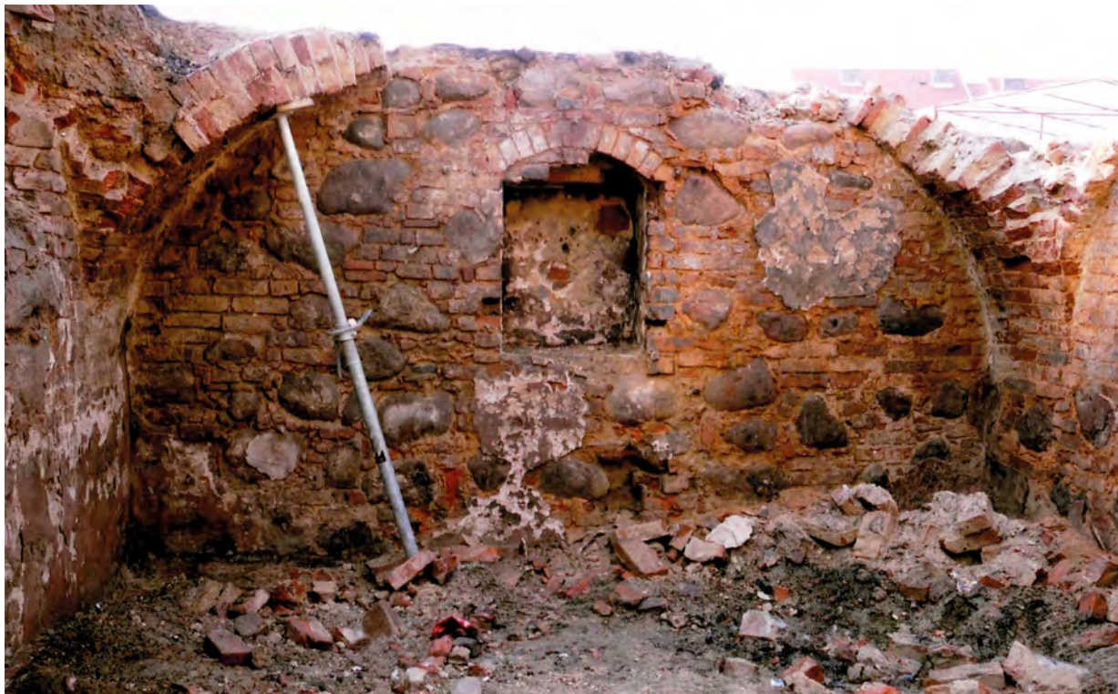
Ryc. 14. Stargard, Stare Miasto, kwartał IX. Ściana W piwnicy tylnego traktu kamienicy Targ Drzewny 19. Fot. T. Balcerzak Abb. 14. Stargard, Altstadt, Quartier IX. Westwand des Kellers des Hintertrakts vom Bürgerhaus in der ehemaligen Holzmarktstraße 19. Foto T. Balcerzak
