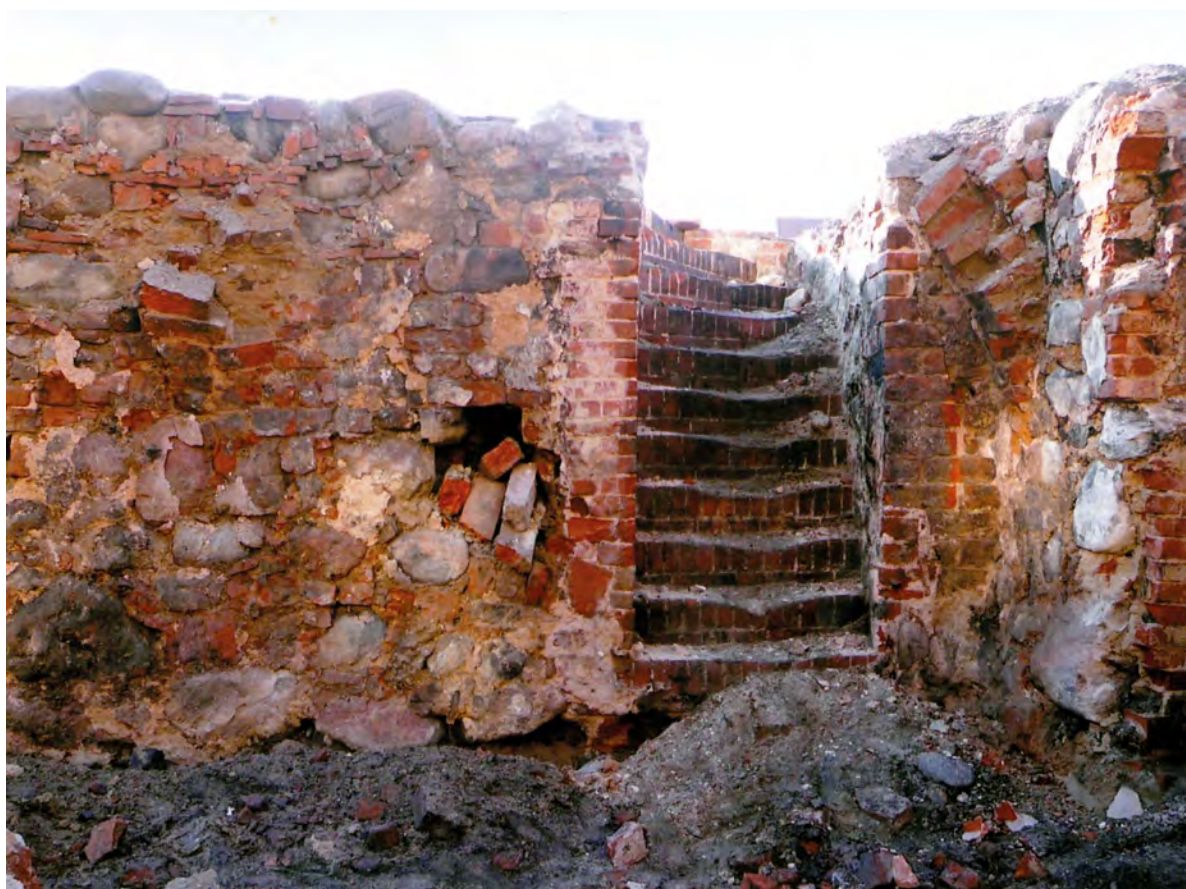
Ryc. 12. Stargard, Stare Miasto, kwartał IX. Schody łączące pierwotnie parter kamienicy Targ Drzewny 19 z piwnicą narożną. Po lewej widoczna schodkowo zamknięta nisza. Widok od NE. Fot. T. Balcerzak Abb. 12. Stargard, Altstadt, Quartier IX. Treppe, die ursprünglich das Erdgeschoss des Bürgerhauses in der ehemaligen Holzmarktstraße 19 mit dem Eckkeller verband. Links ist eine Treppennische zu sehen. Ansicht von Nordosten. Foto T. Balcerzak
