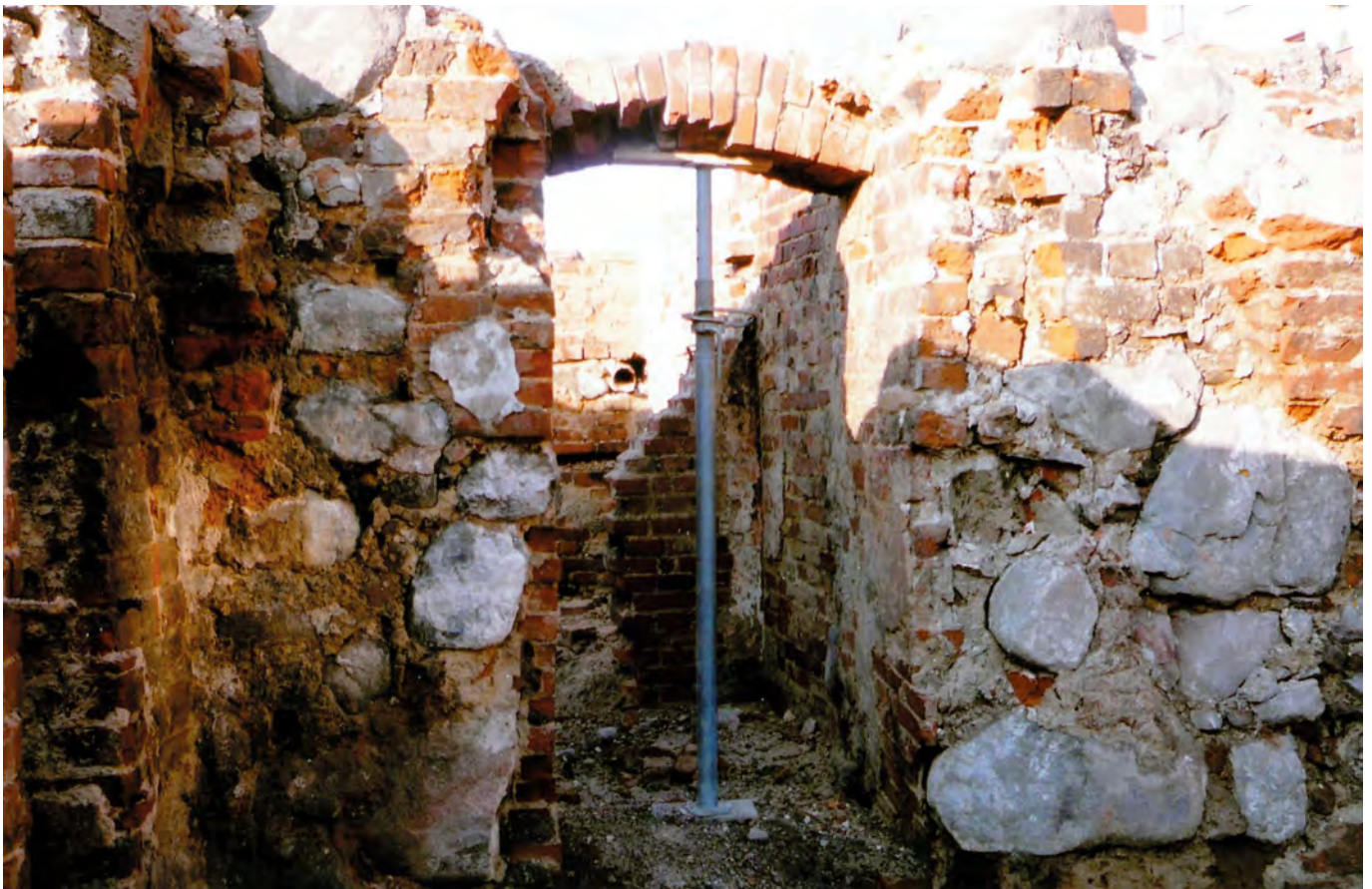
Ryc. 16. Stargard, Stare Miasto, kwartał IX. Przejście pomiędzy narożną piwnicą kamienicy a pierwotną piwnicą budy domu Targ Drzewny 19. Widok od S. Fot. T. Balcerzak Abb. 16. Stargard, Altstadt, Quartier IX. Durchgang zwischen dem Eckkeller des Bürgerhauses und dem ursprünglichen Keller der Bude vom Haus in der ehemaligen Holzmarktstraße 19. Ansicht von Süden. Foto T. Balcerzak
